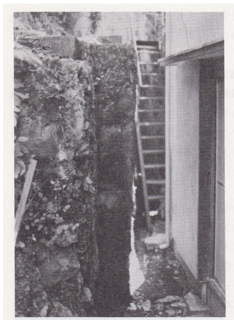
写真2) 石廊崎地区の住宅敷地の断層
